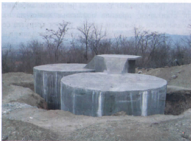
Резервоар за воду у Трњану
